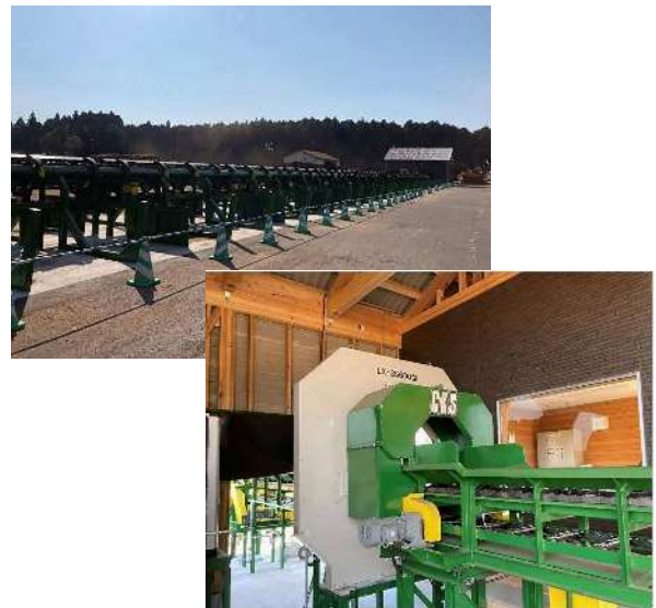
木材加工流通施設の整備 〈選別機〉 (力強い木材産業生産性強化対策事業)
