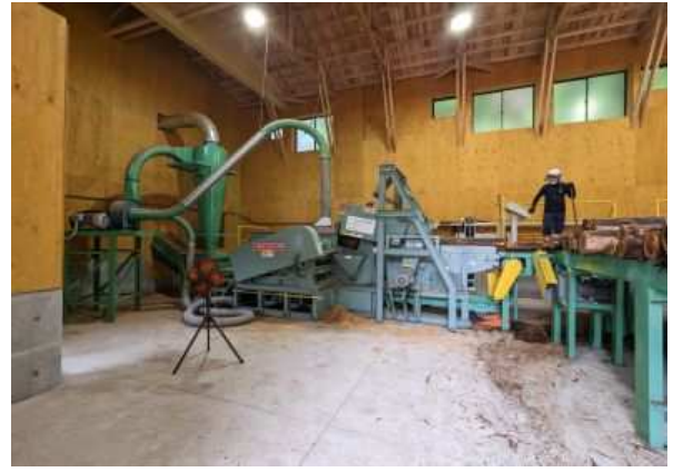
木質バイオマス利用促進施設の整備 〈オガ粉製造施設〉 (林業・木材産業構造改革事業)
