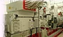
ORC熱電供給設備
