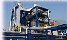
バイオマス燃焼炉・ボイラー
