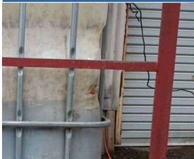
変形したタンク
