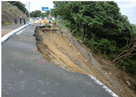
写真1：雨水の浸食に弱いシラス台地の崩壊（鹿児島県肝付町 H24.6）
