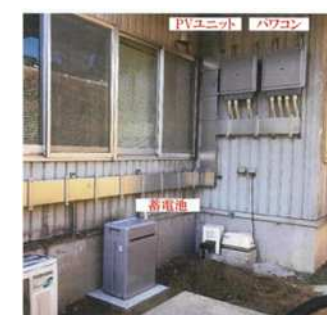
↑蓄電池とパワコン
