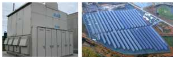
大型蓄電システム施設
