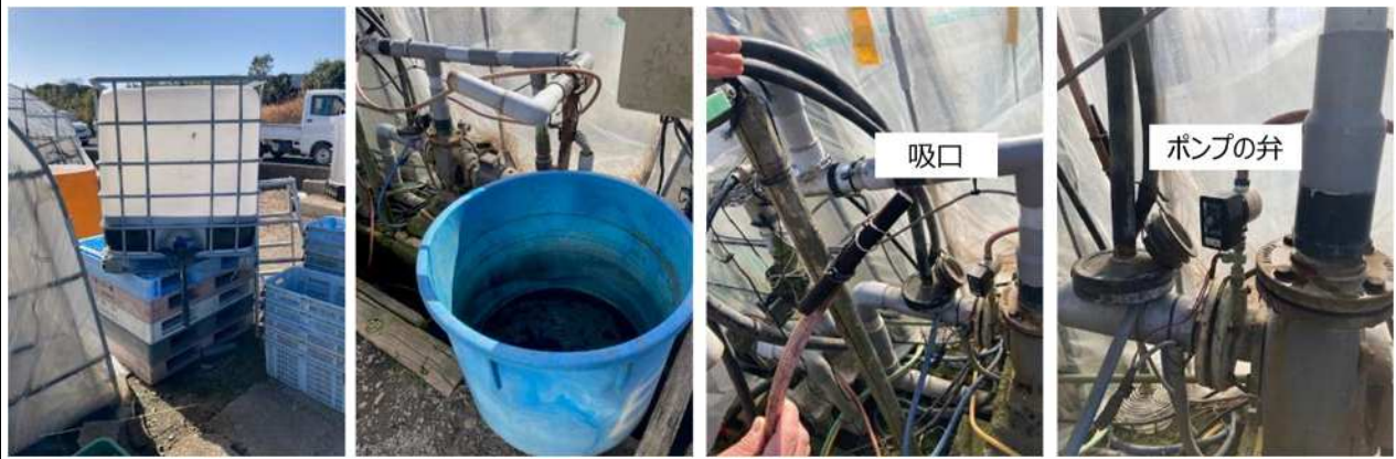
写真 左から、バイオ液肥タンク、水で希釈するためのタンク、灌水設備の吸口、灌水設備のポンプ弁
