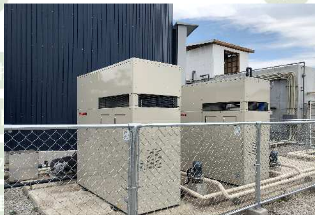
バイオガス発電機
