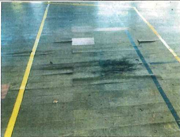
体育館 床部分 破損
