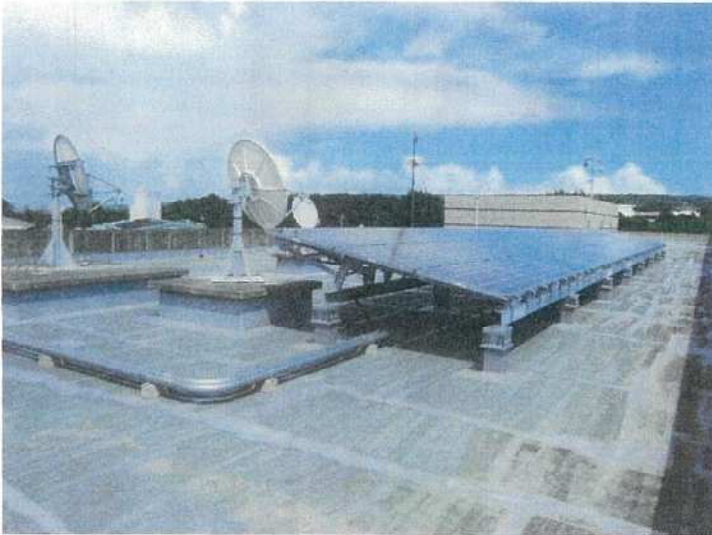
太陽光発電（10 Kw；喜界町役場屋上）
