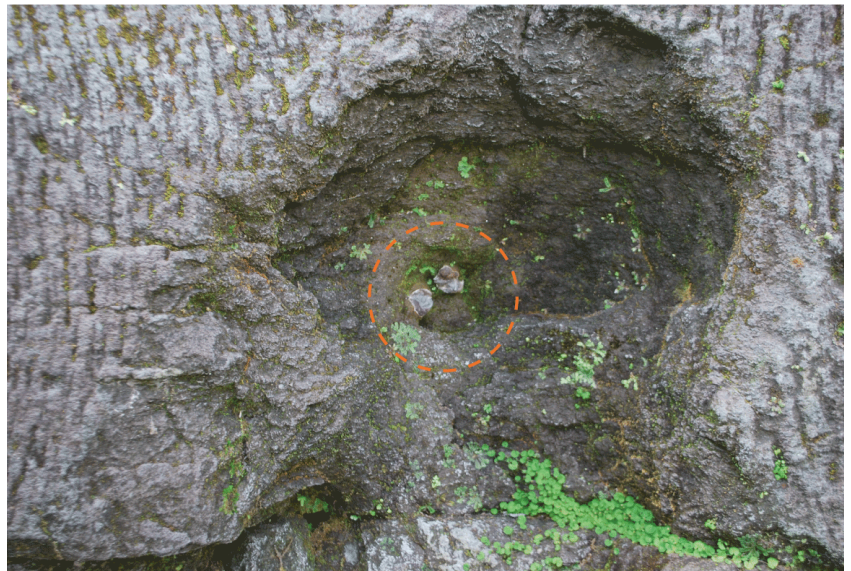
▲ 残留于石墙上的枪炮弹痕和枪弹碎片
