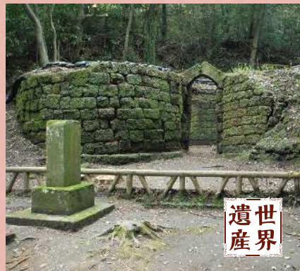
令和5年11月現在、石積み崩落の為、周辺は立ち入り禁止に。一日も早い復旧が望まれる(写真協力：公益社団法人 鹿児島県観光連盟)
