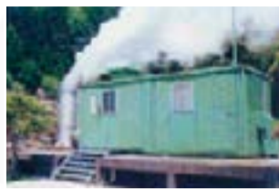
霧島国際ホテル 地熱発電施設(霧島市牧園町)
