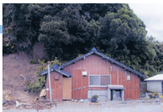
がけ地の崩壊等の恐れのある土地に建っている危険住宅
